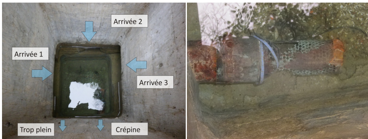
Figure 2 : Aperçu de la chambre de captage et de la crépine d'aspiration.
