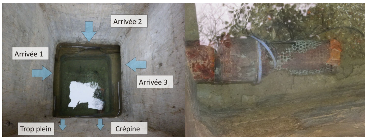
Figure 7 : aperçu de la chambre de captage et de la crépine d'aspiration.
