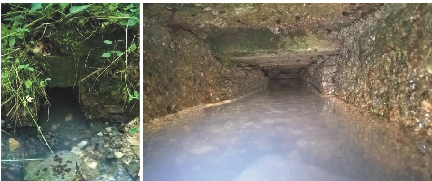
Figure 9 : Vue sur le second trop plein depuis le ruisseau.
